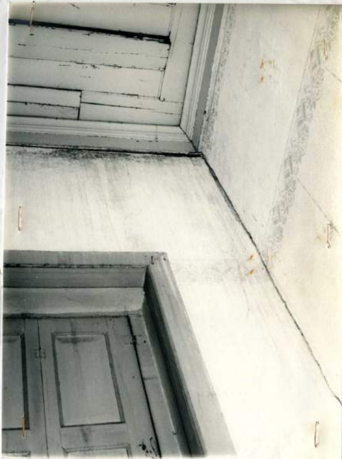
Fenda nas paredes e deterioração do tampo do prédio nº 36, ex-nº 10, da rua Visconde de Araxá- Vaasouras - Est.R.J. (Antiga residência do Barão de Araxá)
